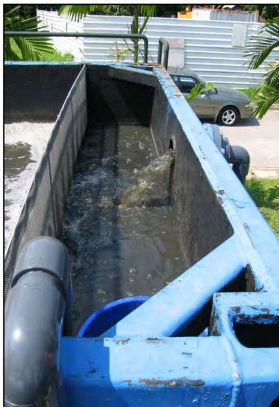
第一部分污水进入筛网池
